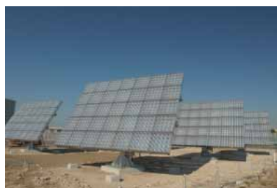
「あいち臨空新エネルギー実証研究エリア」における実証研究 (集光式太陽光発電プラント)
