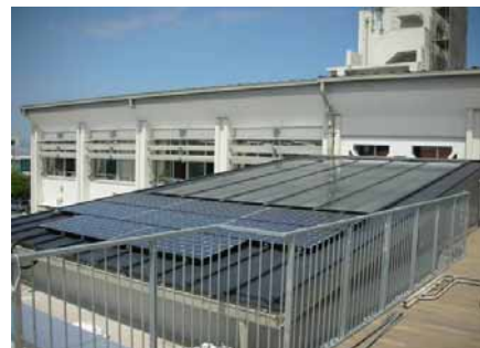
公立学校への太陽光パネルの設置例
