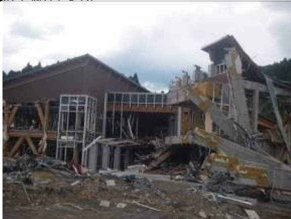
【石巻市役所北上総合支所】 壊滅的な打撃を受けている。 場所は北上川の堤防すぐ脇
