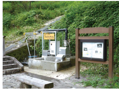
農業用水を利用した小水力発電施設(新城市)
