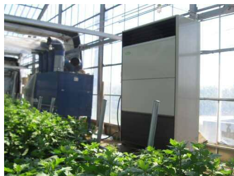
【ハウスに設置されたヒートポンプ】
