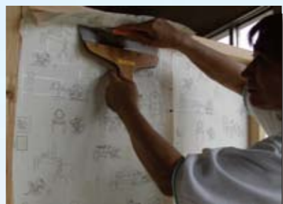
インテリア施工 床・壁の下地施工及びPタイル、タイルカーペット等床仕上げ並びにクロス施工技術を習得します。
