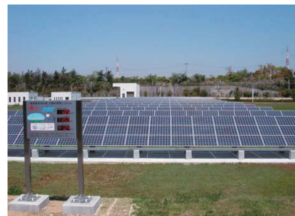
太陽光発電設備（尾張東部浄水場）
