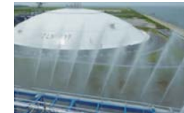
防災設備（水幕設備）
