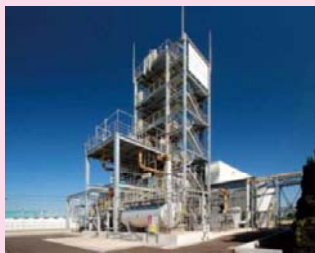
石炭火力発電所に 設置された 二酸化炭素分離回収設備
