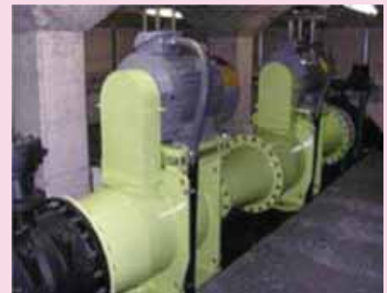
<水道施設への小水力発電の導入例>
