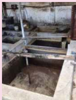
既存の排水処理槽
