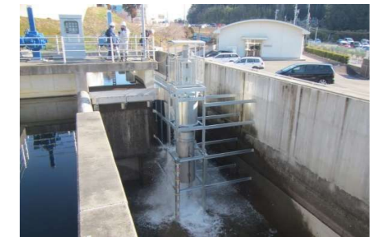
平成 30 年度に運転開始予定の西尾地区（西尾市）の小水力発電施設
