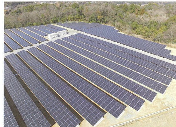
太陽光発電設備（犬山浄水場）
