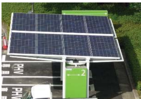
太陽光充電施設
