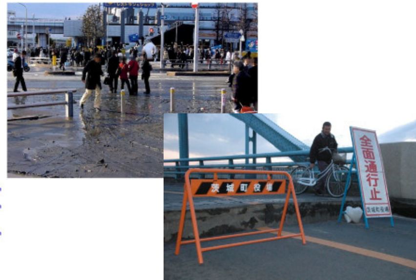
道路の液状化(東日本大震災の例)
