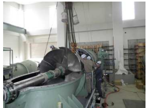
北浜川排水機場 機械類工（西尾市）
