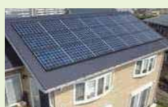
太陽光パネル
