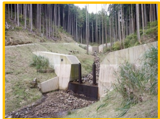
流木を捕捉する機能を持つスリットダム
