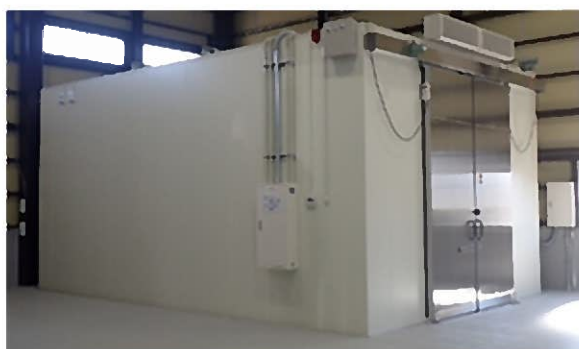
導入された冷蔵庫
