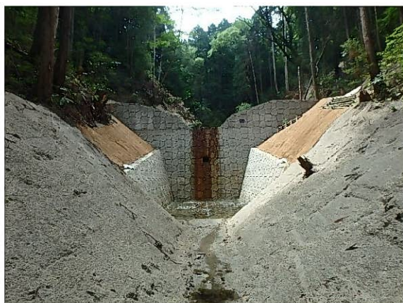
谷止工（瀬戸市）
