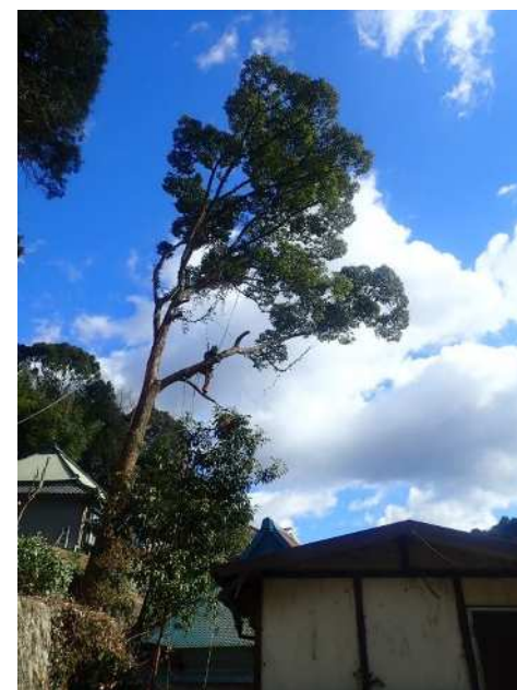
危険な支障木（大径木）の 伐採状況（岡崎市）
