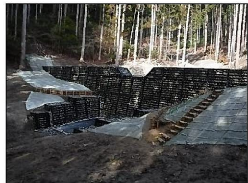
谷止工（鋼製自在枠）（岡崎市）
