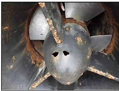
損傷したポンプ
