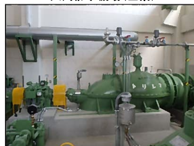
大岡排水機場(ポンプ施設)
