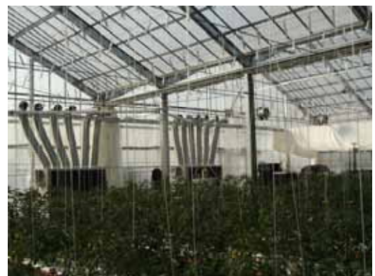
温室設置されたヒートポンプ(トマト)
