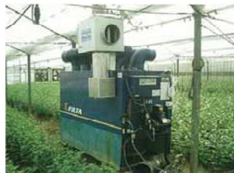
排熱回収装置
