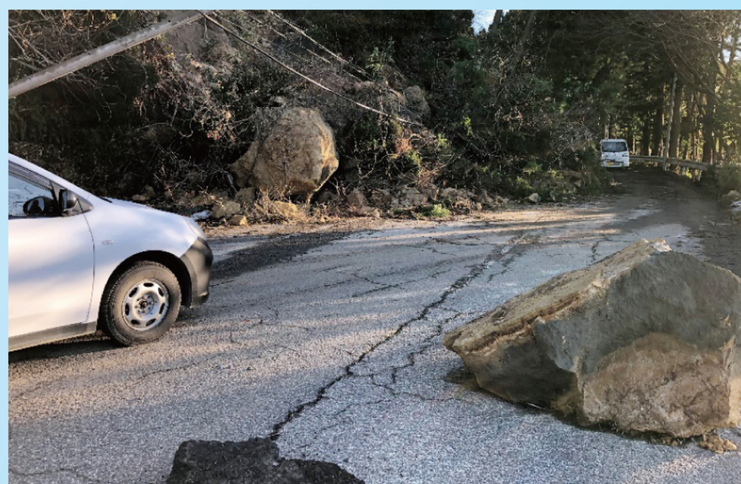
道路被災状況(その1)
