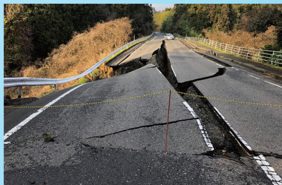
道路被災状況(その2)
