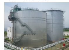
矢作川浄化センター (消化槽)
