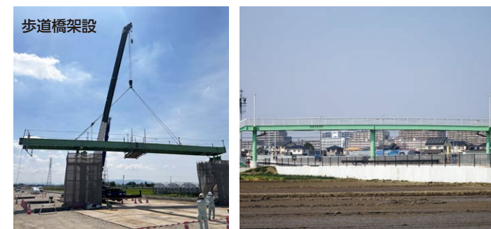
歩行者の安全を確保するため、2023年8月～2024年12月にかけて横断歩道橋を整備しました。
