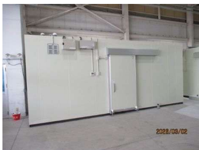
整備された冷凍庫
