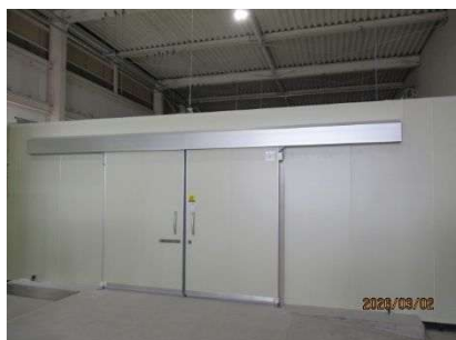
整備された冷蔵庫
