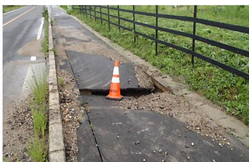
陥没して通行できなくなった歩道
