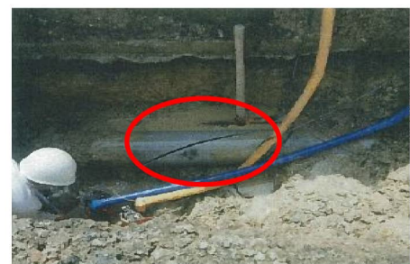
パイプラインの破損状況
