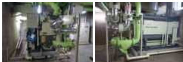
冷温水発生機 (講堂)
