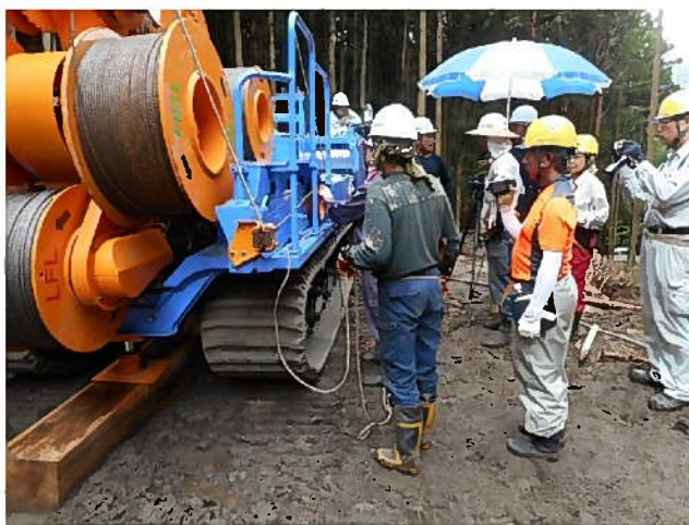
リードロープをプリテンションドラムで巻き取り
