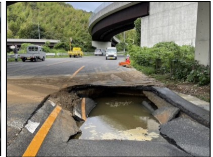
矢作川沿岸 (南部幹線水路の漏水)
