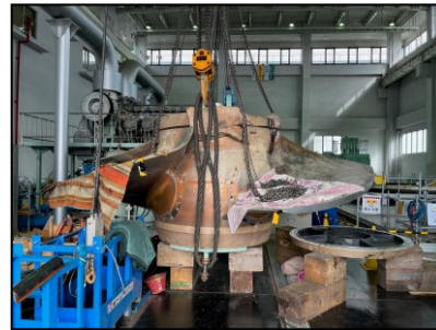
尾張西部 (日光川河口排水機場)
