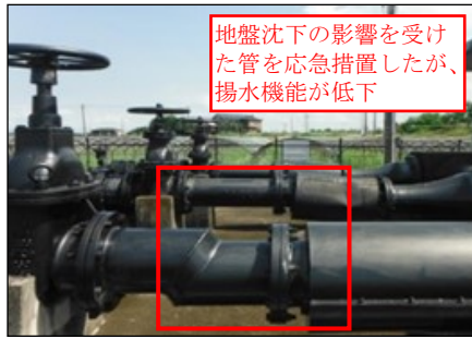
木曽川用水濃尾第二施設改築 (揚水機場の地盤沈下状況)
