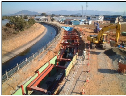
豊川用水二期 (西部幹線併設水路)
