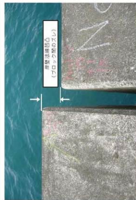
参考写真① 岸壁法線の凹凸 (ブロック間のズレ)
