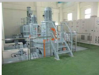
新堀川1期地区(根高排水機場ポンプ)
