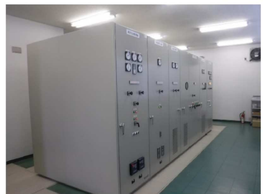
【農業用排水機の整備】 (弥富市)
