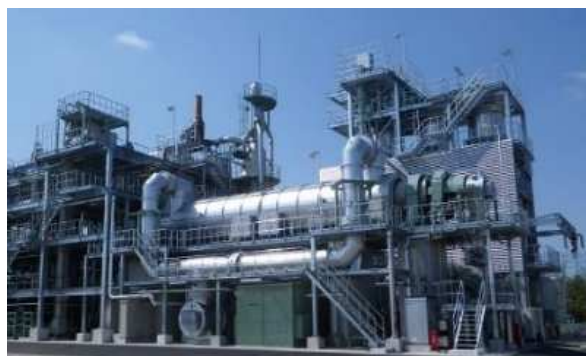
衣浦東部浄化センター 下水汚泥燃料化施設
