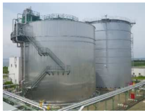
矢作川浄化センター 下水汚泥メタン発酵施設
