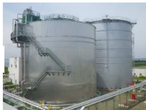
矢作川浄化センター 下水汚泥メタン発酵施設
