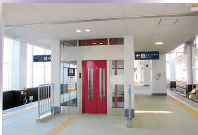
駅に設置されたエレベーター
