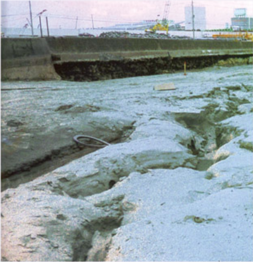
地震の揺れで液状化が発生し、地面が陥没した臨海部の港湾施設(平成7年阪神・淡路大震災) 写真提供: 尼崎市
