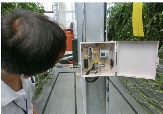
「CO 2 当盤」：炭酸ガスの濃度をコントロールする。
