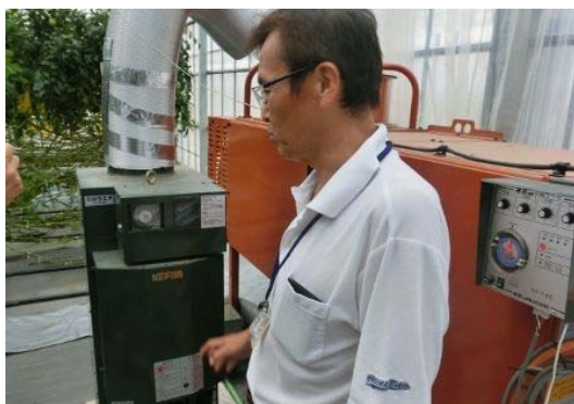
炭酸ガス発生装置：「グロウエア」。 灯油を燃やしたときの排気を利用。 工場等から出る炭酸ガスを有効活用 できることが環境的にはベスト。 夏場は喚起するので使用しない。
