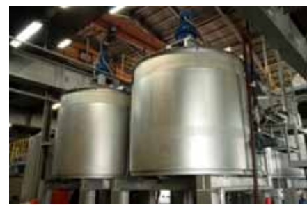
バイオエタノールの製造プラント
