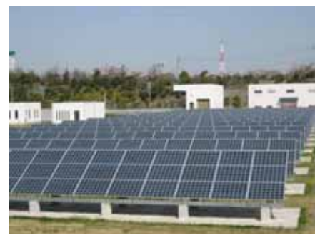
尾張東部浄水場に設置した太陽光発電施設
