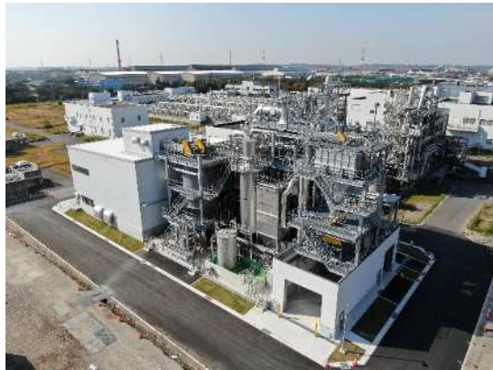
衣浦西部浄化センター焼却炉
