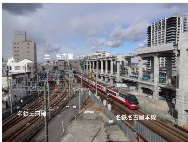
図表4-1-7 知立駅付近連続立体交差事業の工事状況（2023年1月撮影）
