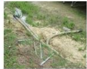
※送電ケーブルが切断、窃取された状況
