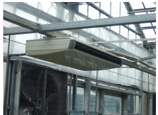
ヒートポンプエアコン本体（西尾市）
