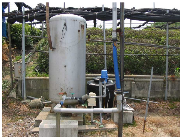
大幅な減肥が可能な点滴施肥装置（西尾市）
