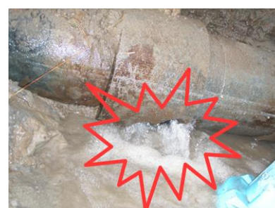
石綿セメント管 破損状況
