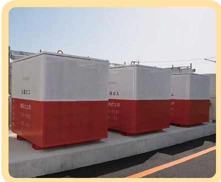
水素カードル (車両衝突防止)
