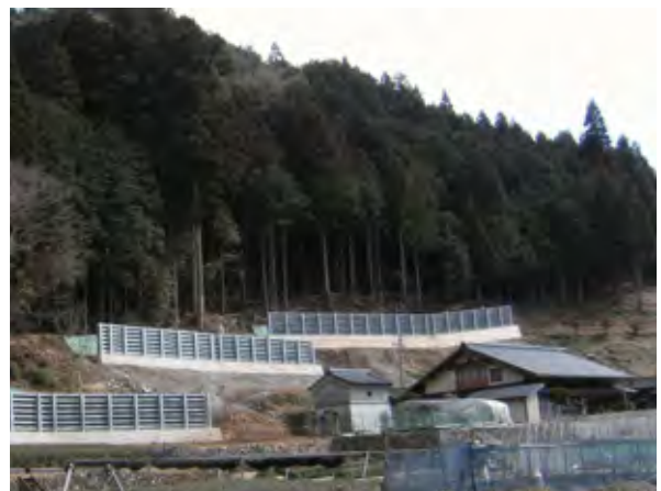
山地災害から住宅等を守る落石防護柵
