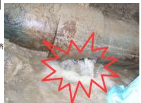
石綿セメント管 破損状況
