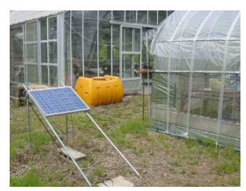
太陽光発電による電源の確保
