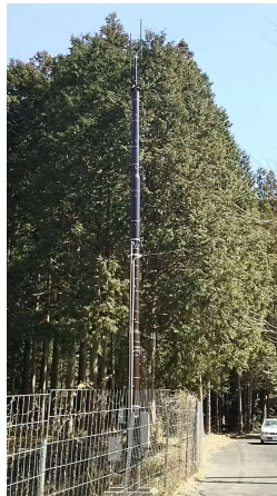
携帯電話基地局 (新城市一色地区)
