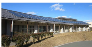
太陽光発電設備
