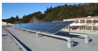
太陽光発電設備
