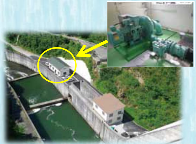
発電機 (大島ダム)
