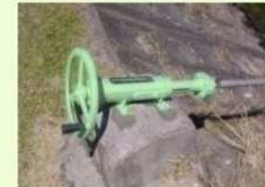
ゲート、バルブの更新
